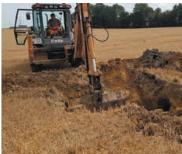
Déblaiement d'un tuyau de décharge défectueux dans les campagnes derrière la Tinlotoise à Soheit-Tinlot.
